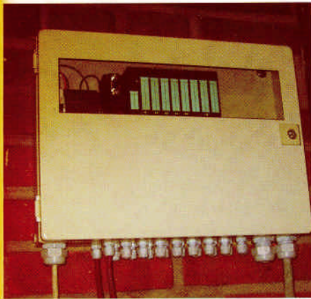
Der Aufwand für das Engineering, um die Stromwerte zu erfassen und über das dezentrale Peripherie-System ET200S an die Regelung der Lüfter zu übertragen, war nur gering
