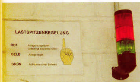
Mit einem umfassenden Energiemanagement hat man ein Auge auf den Energieverbrauch und kann entsprechende Maßnahmen innerhalb der Produktion treffen
